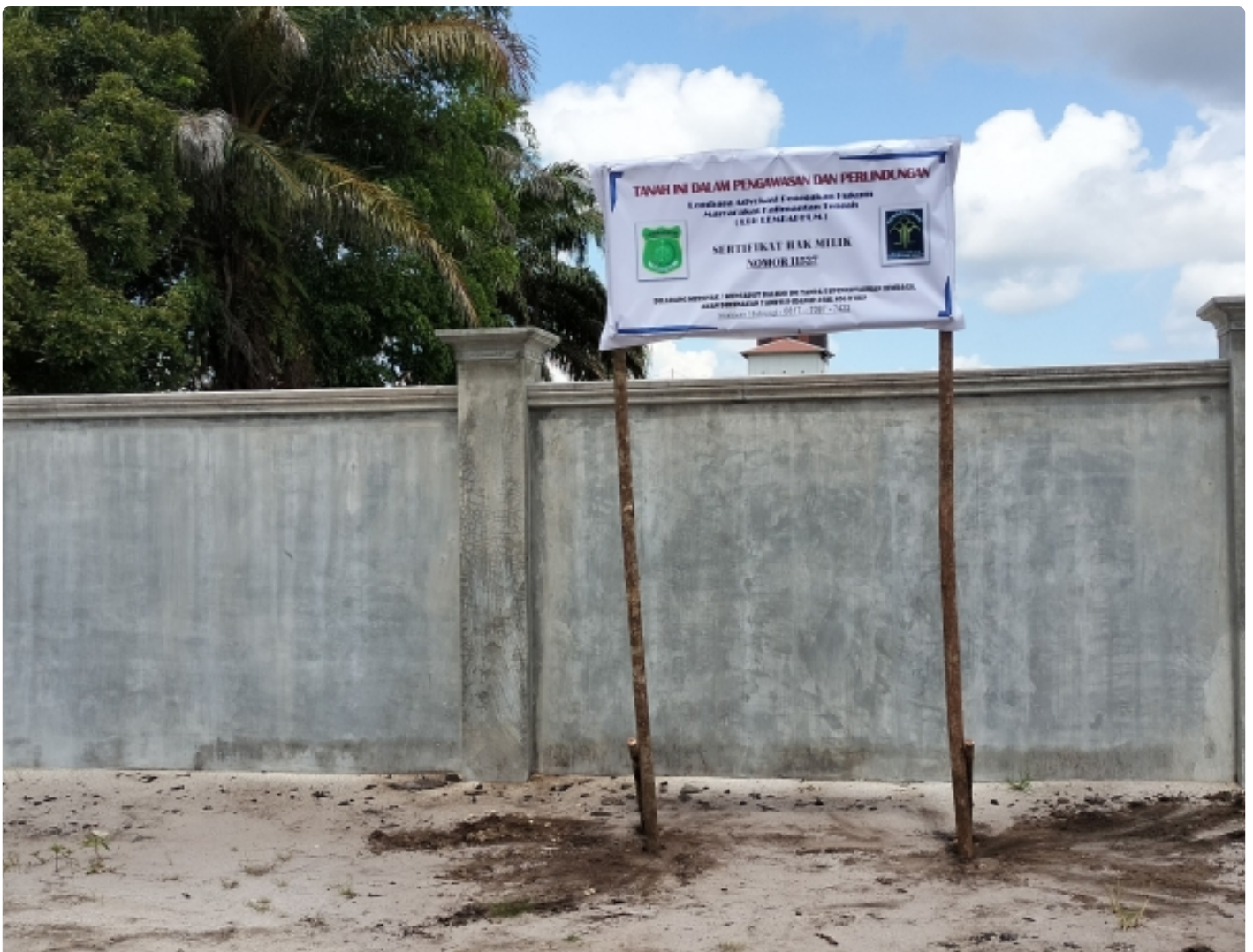
Gambar: Pagar Beton yang dibangun Oknum dengan mengambil atau mengalih punsi jalan Boreno IB
