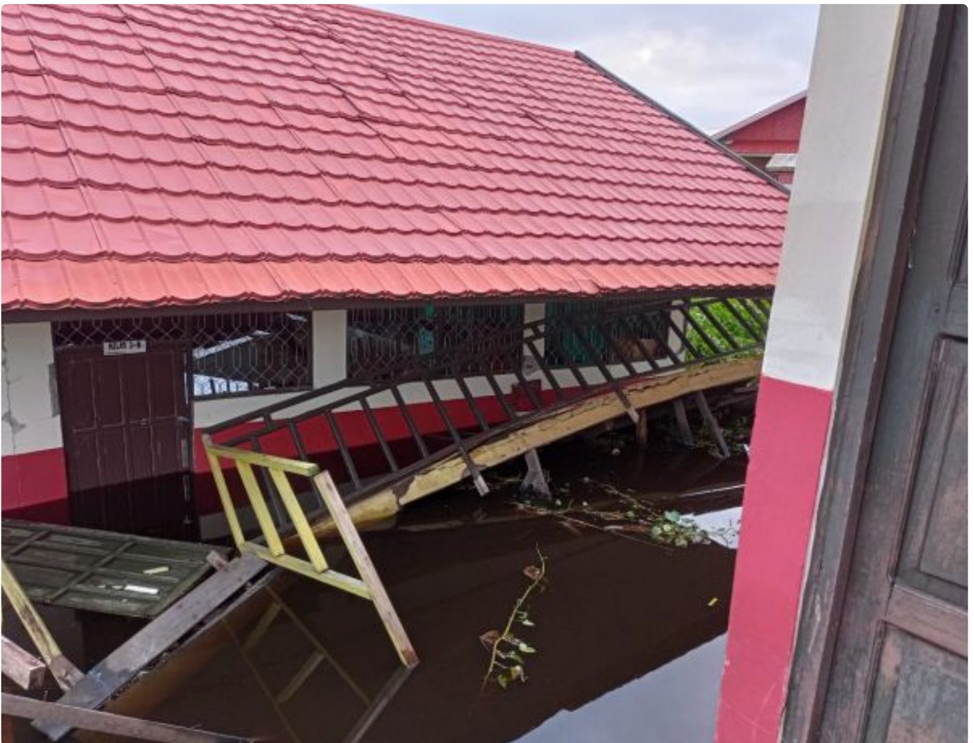
Bangunan SDN 14 Palangka Raya yang ambruk
